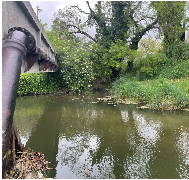
Point d'intérêt n°1 : Aménagement et inondation
